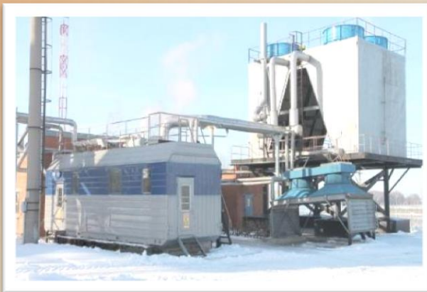
Утилизационная установка БУТЭК-0.5 мощностью 0.5 МВт (э) на водяном паре.
